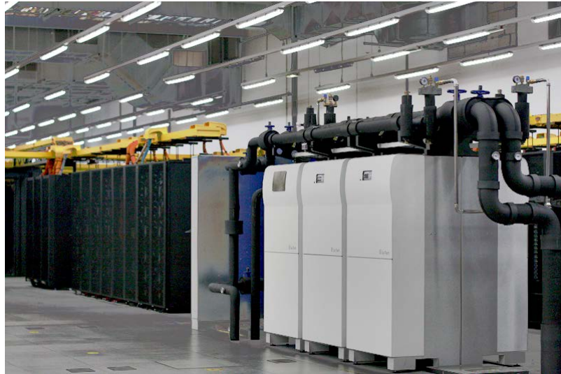
Abbildung 23: CoolMUC-2-Rechnerracks (schwarze Racks) und 6 von der Abwärme der Rechnerracks betriebene Adsorptionskältemaschinen (hellgraue Geräte rechts im Bild)
